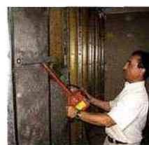
Ouate de cellulose Égalisation avec fraise rotative avant pose du parement. (Doc. Univercell)
